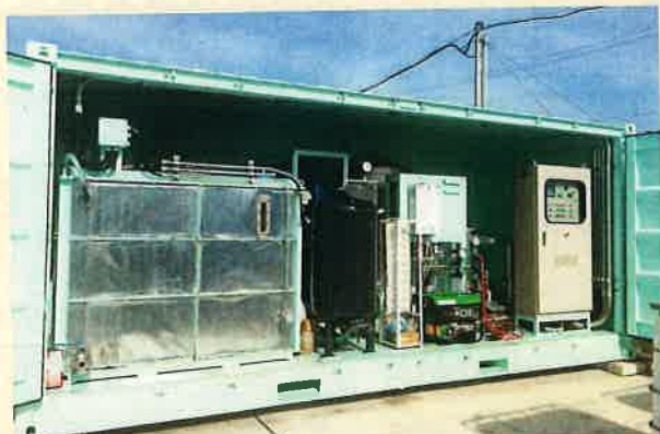
小型メタンガス発電プラント
